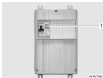
Afb. 157 230-V-zekeringenkast met beveiligingsautomaat en FI-schakelaar
